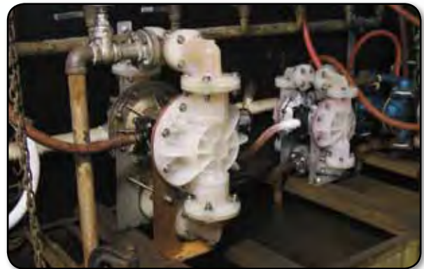
Bombas de polipropileno de uso estándar instaladas para el procesamiento de productos químicos.
