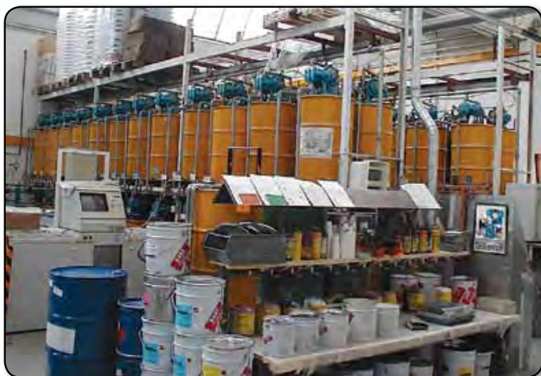
Bombas de válvula de bola de 1" instaladas en una operación de mezcla de pintura y coloración.
