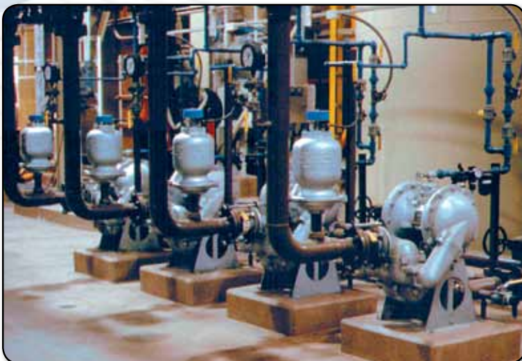
Bombas HDB con descarga inferior con puertos y tranquilizadores en una instalación de tratamiento de desechos industriales.
