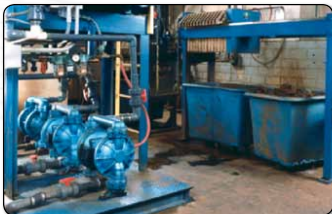
Bombas de uso estándar metálicas que manipulan sólidos en suspensión en una operación de tratamiento de desechos industriales.
